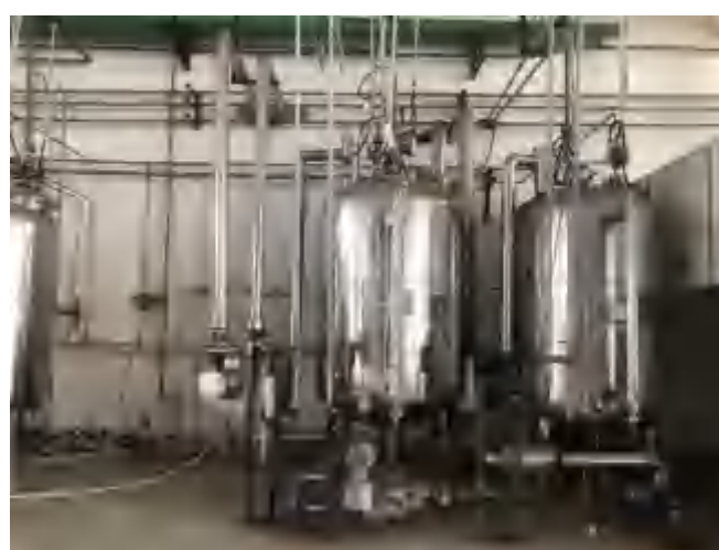
103 物料间废液收集罐
