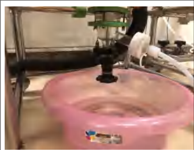
原料药车间导淋装置
