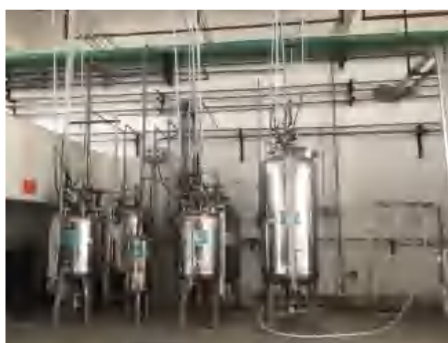
102 物料间废液收集罐
