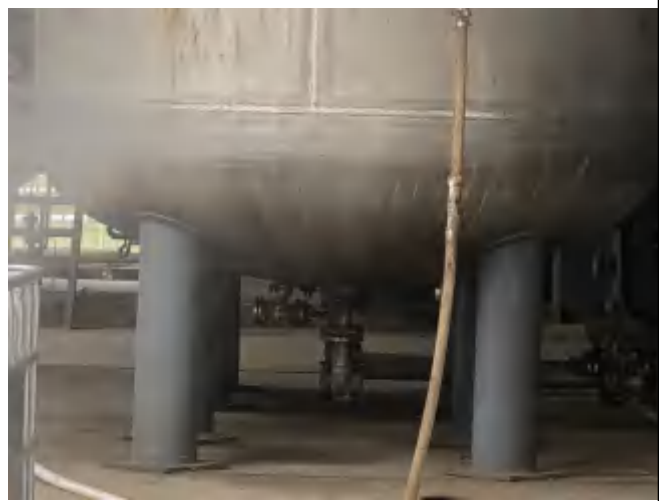
溶剂回收车间导淋装置
