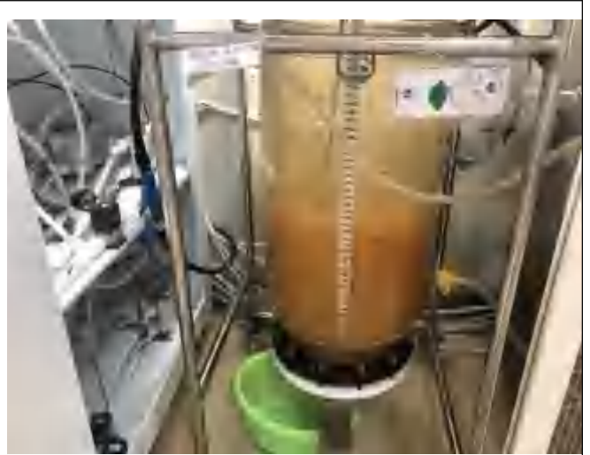
原料药车间导淋装置
