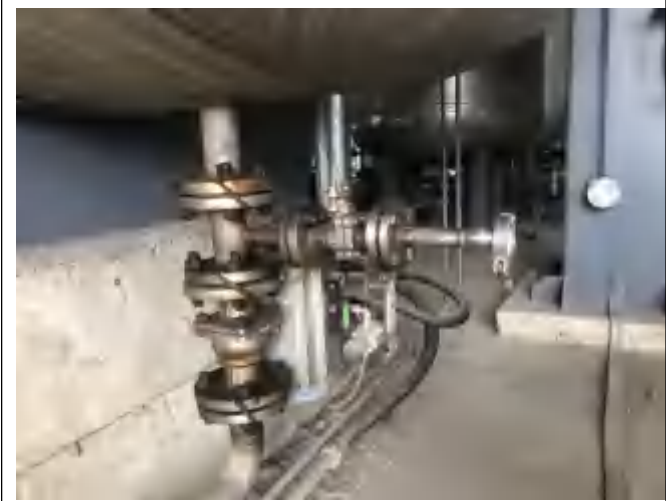
溶剂回收车间导淋装置
